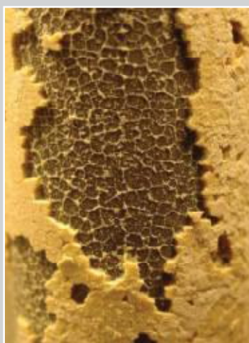
Důlková koroze způsobená vysokým obsahem minerálů ve vodě
